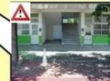
地點：樓梯口 原因：地面不平
